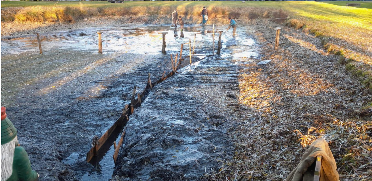
Degradované břehy navazující na hráz stavidla s obnaženými a popraskanými boky hráze stavidla a rozpadlý požerák ve vypuštěném rybníku na konci prosince 2024
