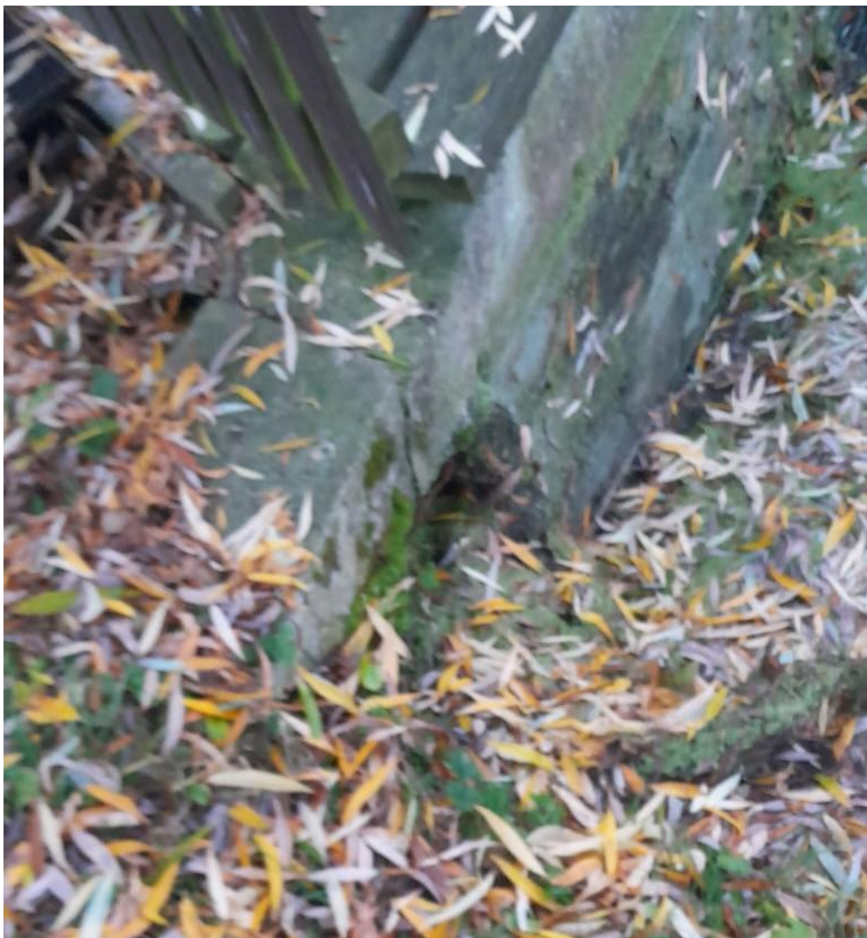
Obnažený a prasklý bok hráze stavidla s klesající hladinou rybníka v říjnu 2024
