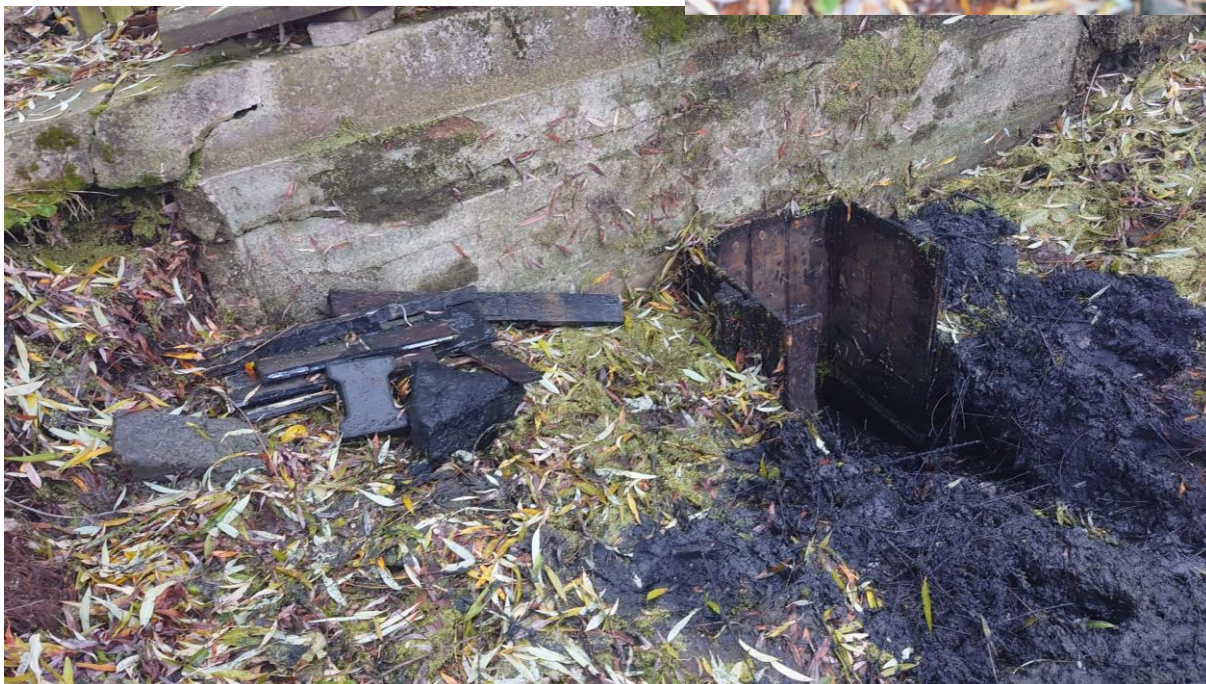
Obnažené a popraskané boky hráze stavidla s rozpadlým požerákem ve vypuštěném rybníku v prosinci 2024
